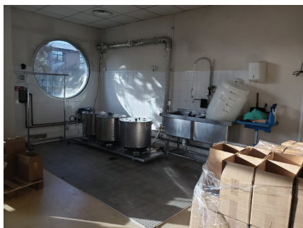
Local dans lequel sera installé l'unité de lavage – Les amis de Germenoy
